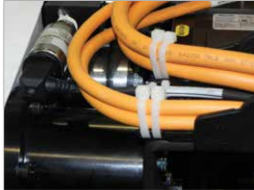
Abbildung 7-2 Mit Kabelbindern gesicherte Kabel
