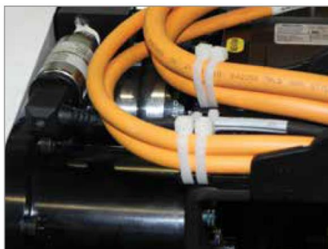
图像 7-2 用捆扎带固定的电缆
