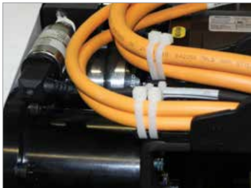
Obrázek 7-2 Kabely uchycené stahovacími páskami
