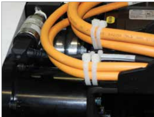
Figura 7-2 Cables sostenidos con bridas de alambre
