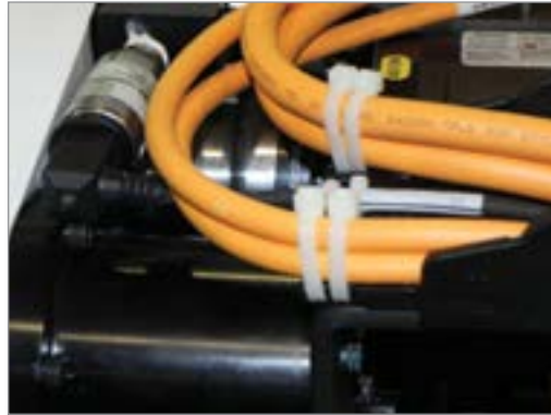
Figur 7-2 Kabler, der holdes med kabelbånd
