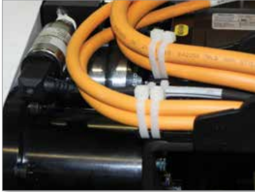
Afbeelding 7-2 Kabels vastgezet met kabelbinders
