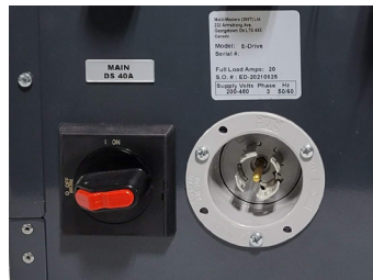
Figure 10-1 Trennschalter und Netzanschluss
